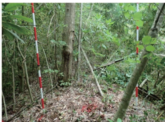
現地調査での事例（堤体に樹木が生長）
