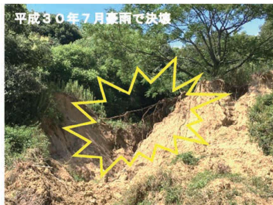
パイピング発生事例（堤体内に根が伸長）
